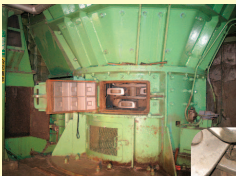
破碎機とその内部
